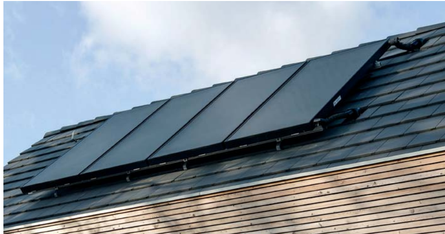
Sonnenkollektoren Vitosol 200-FM
